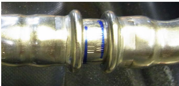
Abb. 6 (Vor der Prüfung) Nahansicht Verbindung Edelstahl
