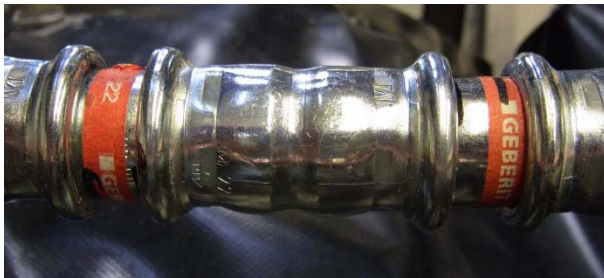
Abb. 4 (Vor der Prüfung) Nahansicht Verbindung C-Stahl
